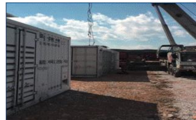
35kV/4MVA新能源测试平台
